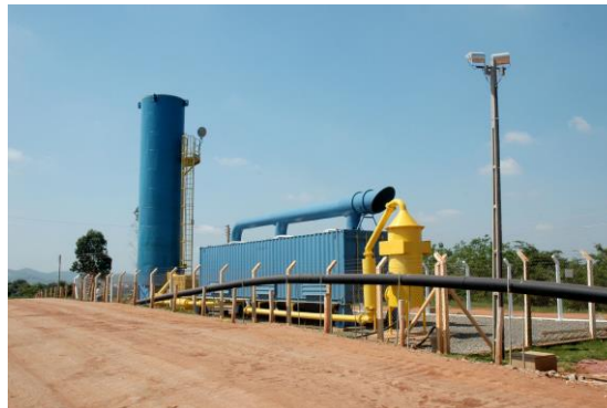
Estação de captação do biogás
